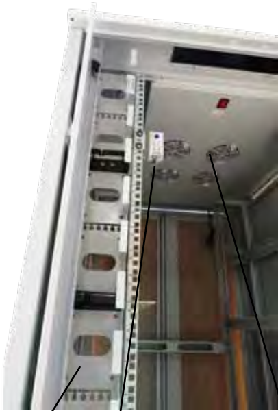
Kabelkanal, Temperatureinheit, Lüfter
